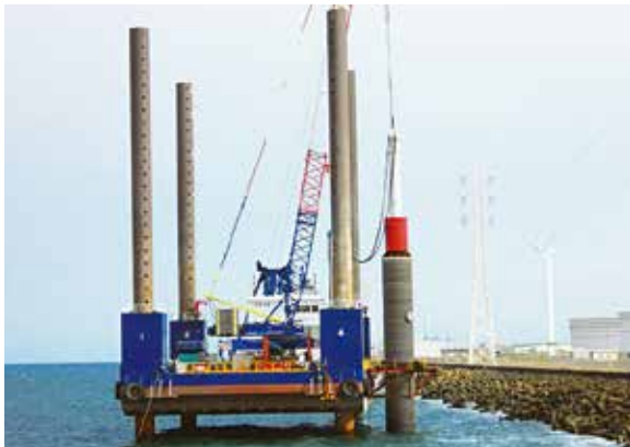
洋上風力発電事業 SEPにてモノパイル打設を行う 茨城県：神栖沖
